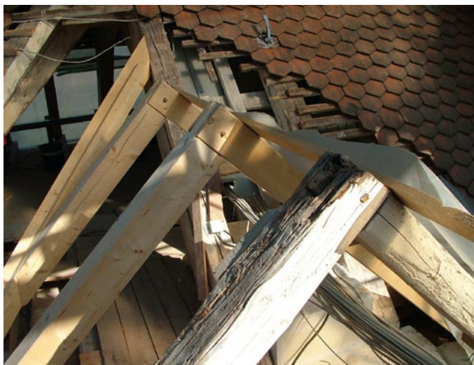
Mangelnder Luftwechsel in den Dachstühlen brachte Fäulnis ins Holz, im Hintergrund die Alt-Deckung der spitz zulaufenden Biber.
