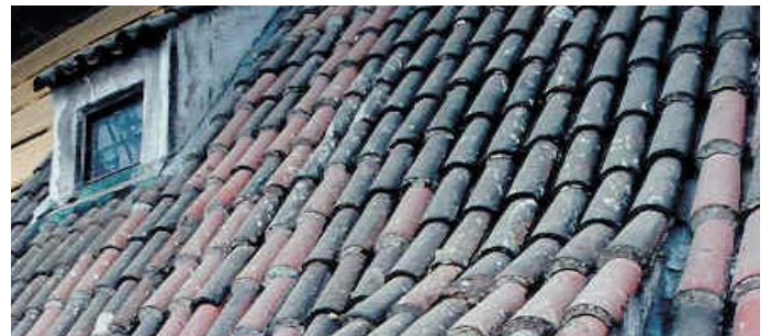
Während im Vordergrund noch die alte Mönch-/Nonnen-Deckung mit Mörtelbett zu sehen ist, läuft weiter hinten bereits die Sanierung
